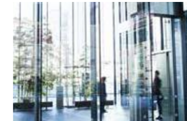
PORTA NUOVA BONNET N. 4 AHU - 150.000 m³/h Milano (IT)
